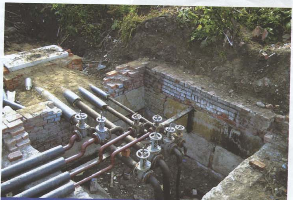
Трубы, утепленные пенополиуретаном
