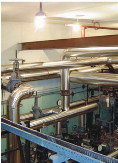
Распределительная подстанция городских тепловых сетей
