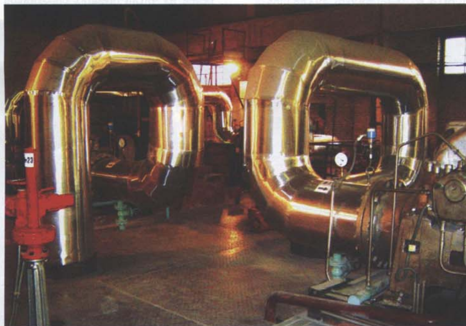
Повышающая насосная станция в Новокузнецке
